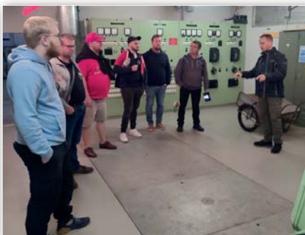
Strojovna v bunkru
